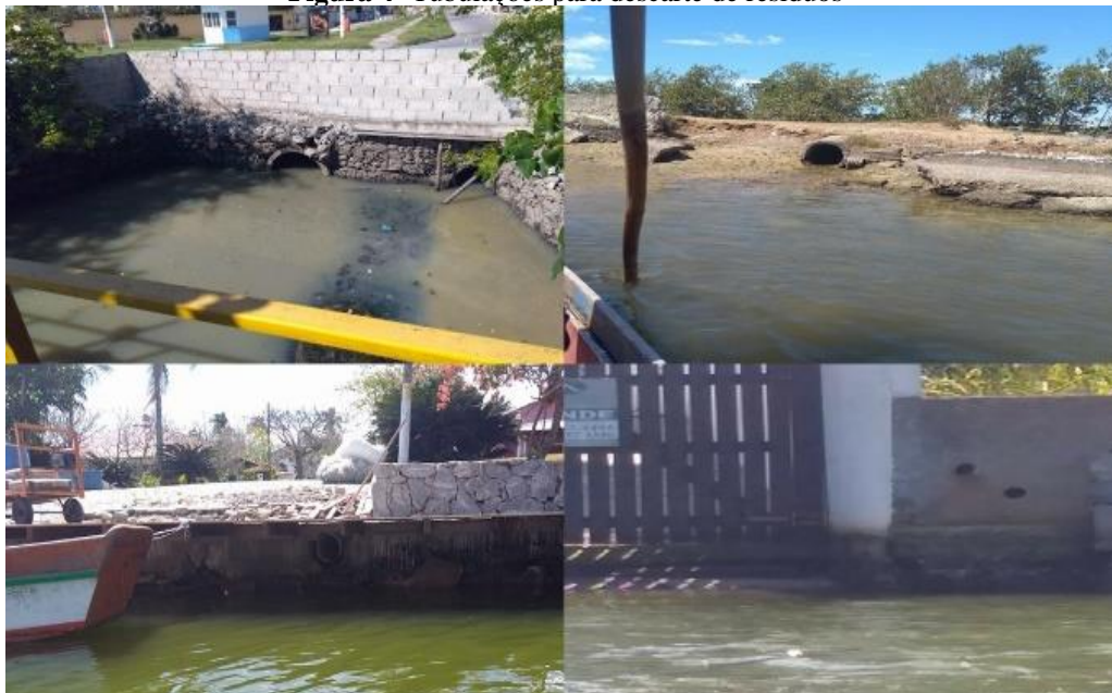
Figura 4- Tubulações para descarte de resíduos
